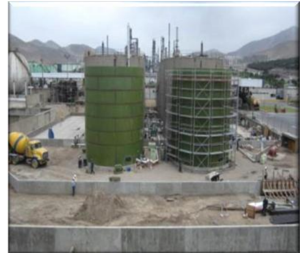
Ampliación planta de asfaltos
